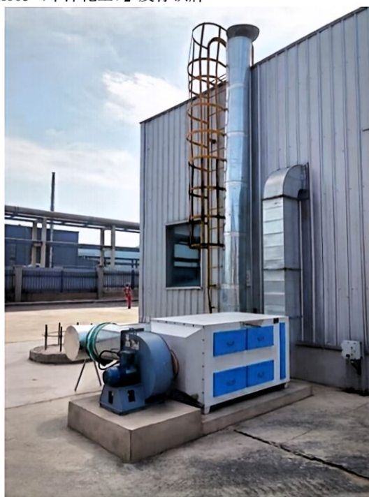
危废库废气排气筒 DA008
