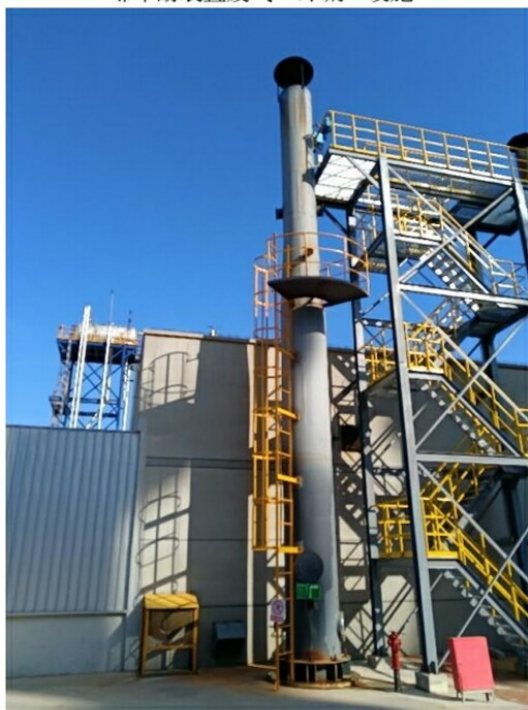
导热油炉废气排气筒 DA006 及标识牌
