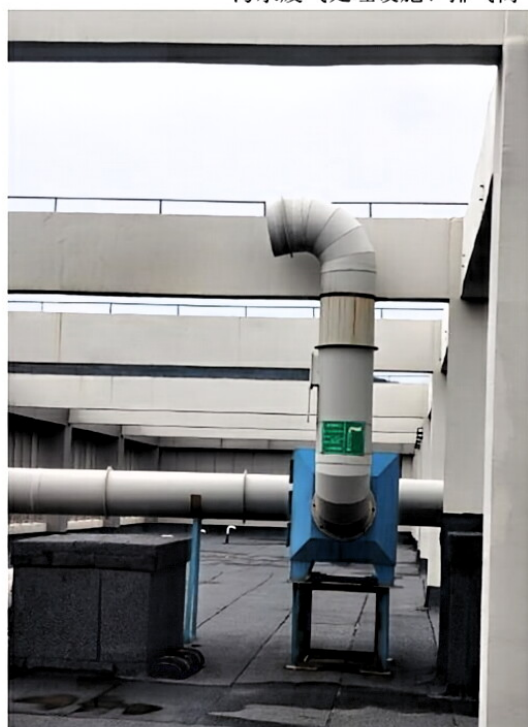
化验室废气排气筒【DA007（中沐化工）】、标识牌
