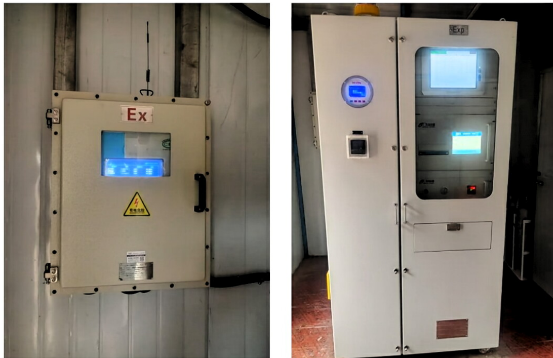
非甲烷总烃在线监测设施
